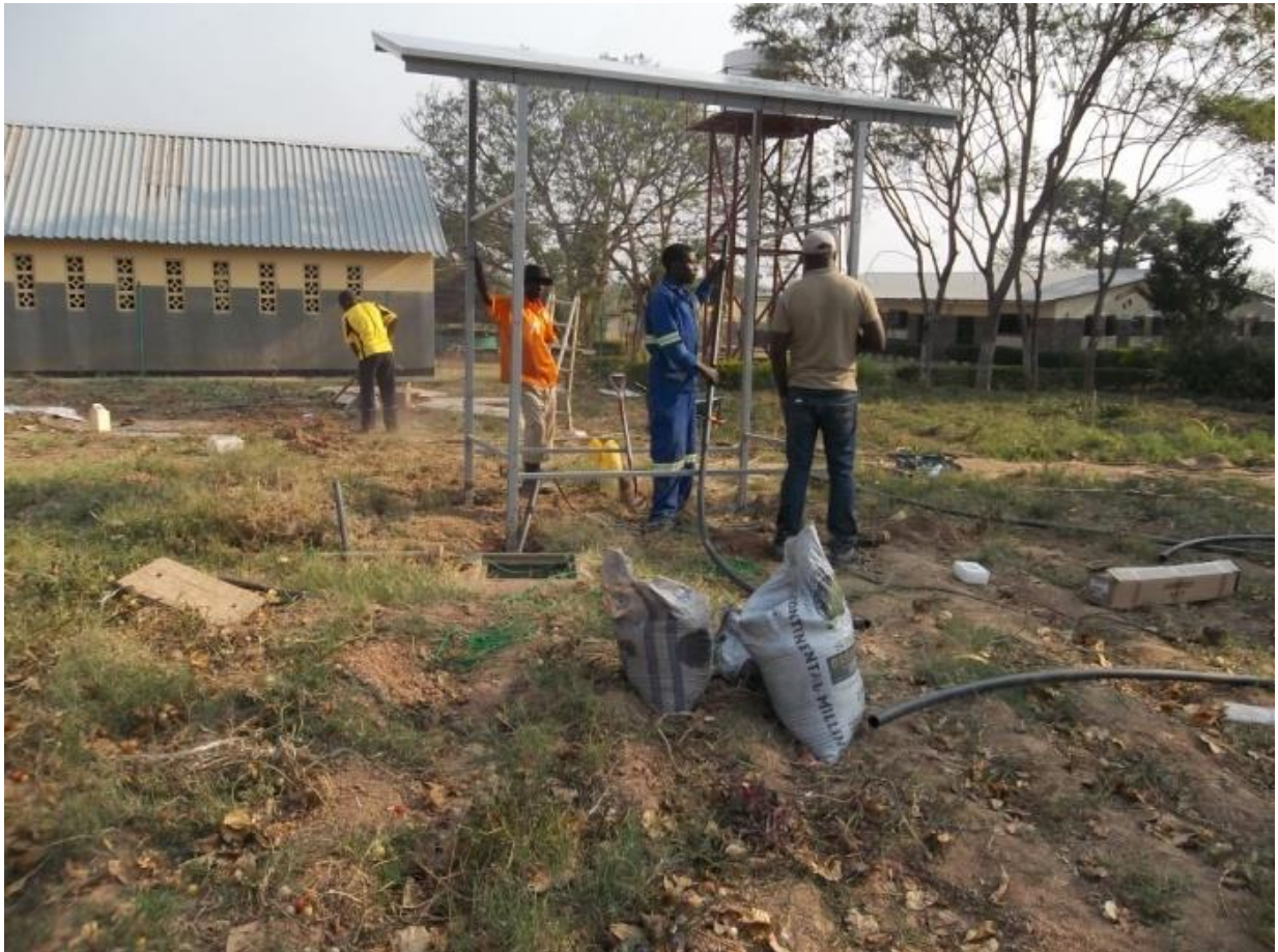
Das neue Solarpanel
